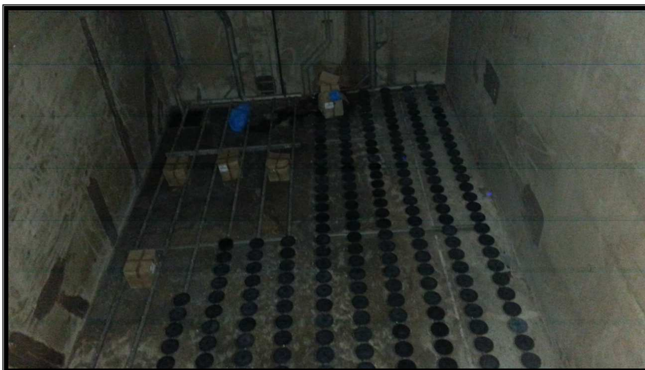
Mise en place des nouvelles membranes dans le réacteur Biolix.
