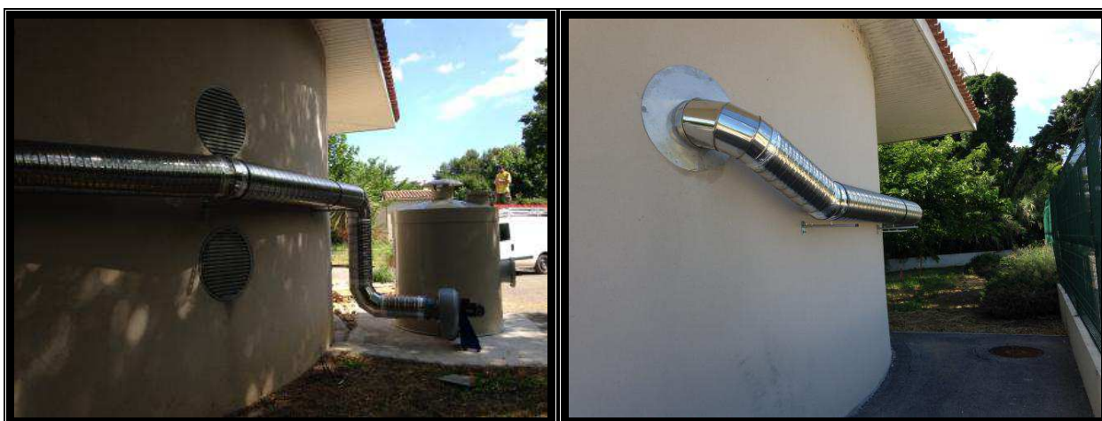
Désodorisation au charbon actif installée sur le PR Pont Trinquat pour traiter l'air de la cale humide.
