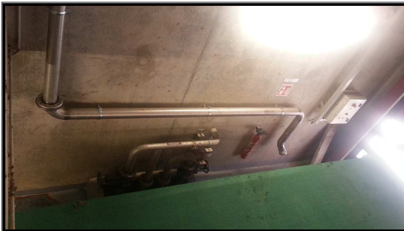
Cheminement de la colonne sèche pour accéder aux dégrilleurs fins.
