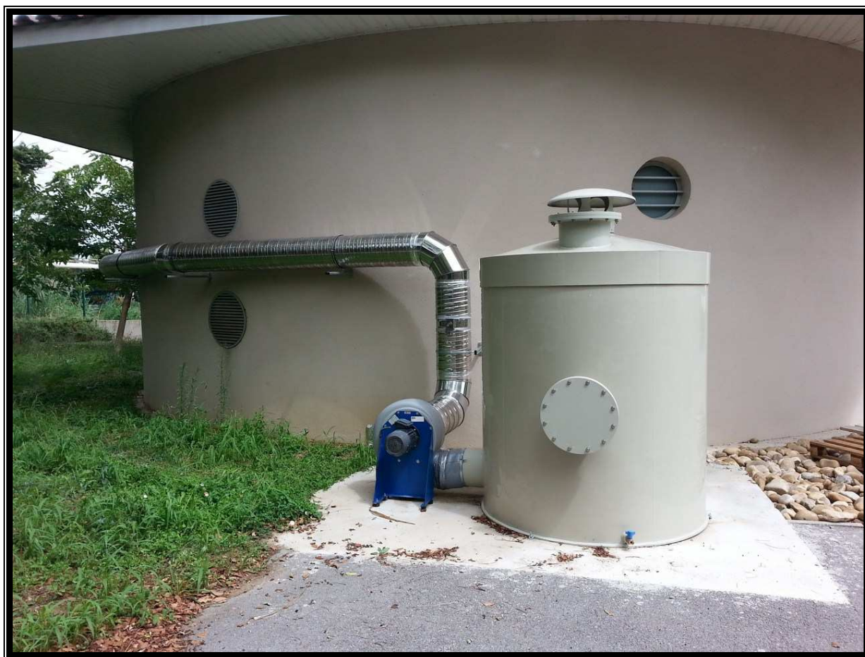
Désodorisation installée au PR Pont Trinquat.
