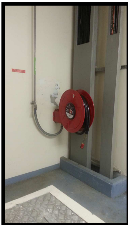
Un des 17 nouveaux RIA installés.
