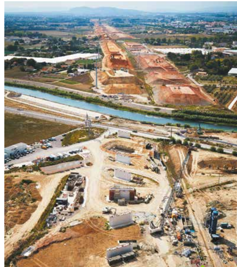
Dans le cadre du Contournement Ferré Nîmes-Montpellier, un viaduc est en construction entre Lattes et Montpellier. D'ici 2016, cet ouvrage long de 90 mètres permettra aux trains de franchir le Lez.
