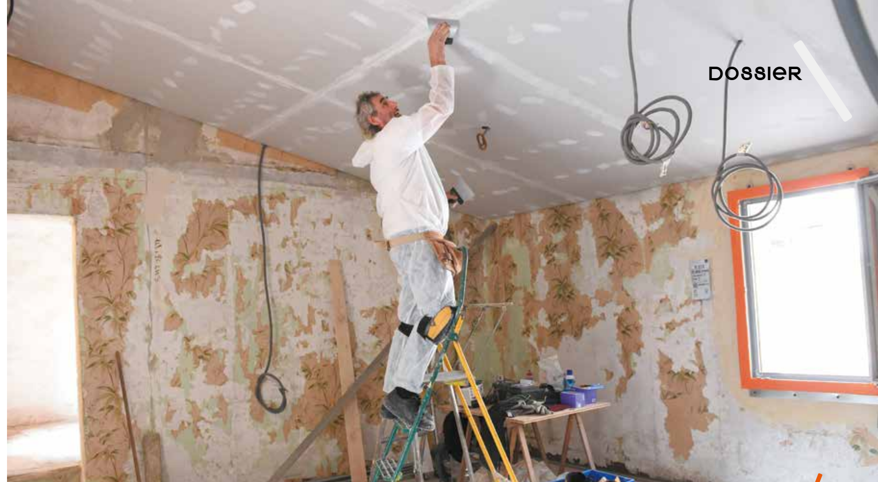
D'ici 2018, 550 logements vont bénéficier d'une rénovation thermique grâce à l'opération Rénover pour un habitat durable et solidaire.
