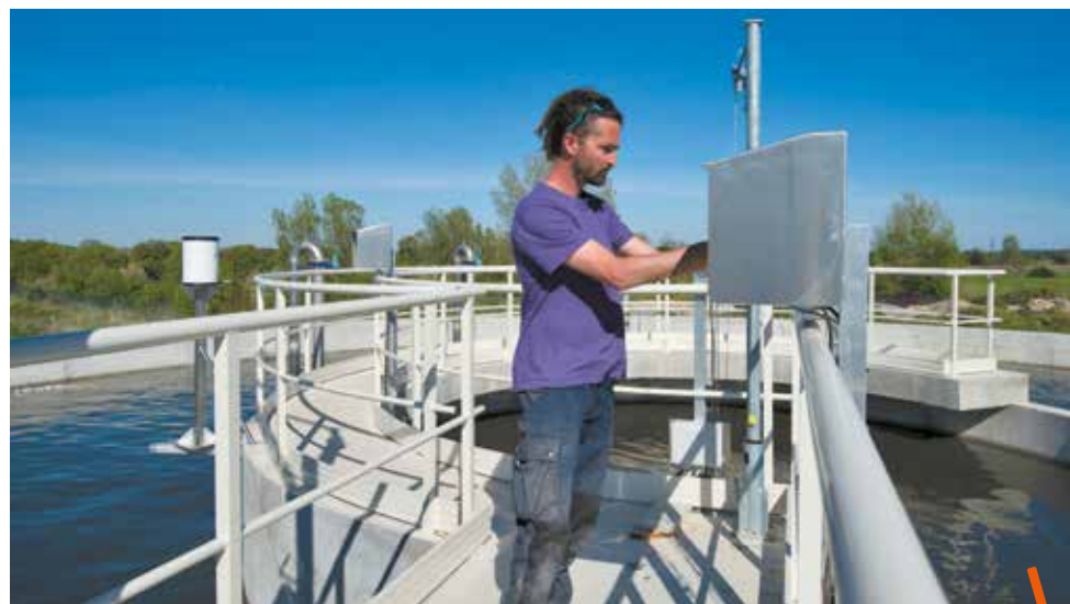
La station d'épuration de Courmonterral et Cournonsec, réhabilitée en 2005, a été modernisée et sa capacité doublée (à 15 000 habitants), de façon à répondre aux besoins futurs sans générer d'impact sur l'environnement. Livrée en avril dernier, cette station a coûté 4 M€.
