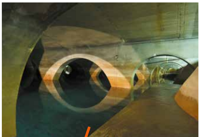
Le réservoir d'eau potable de Montmaur.
