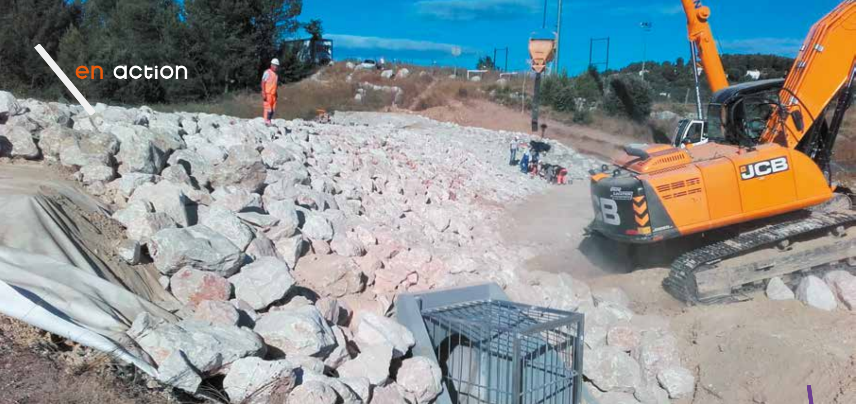
Le bassin de rétention G de Grabels a été conforté et mis en sécurité lors de travaux effectués cet été par la Métropole pour un montant de 200 000 euros.
