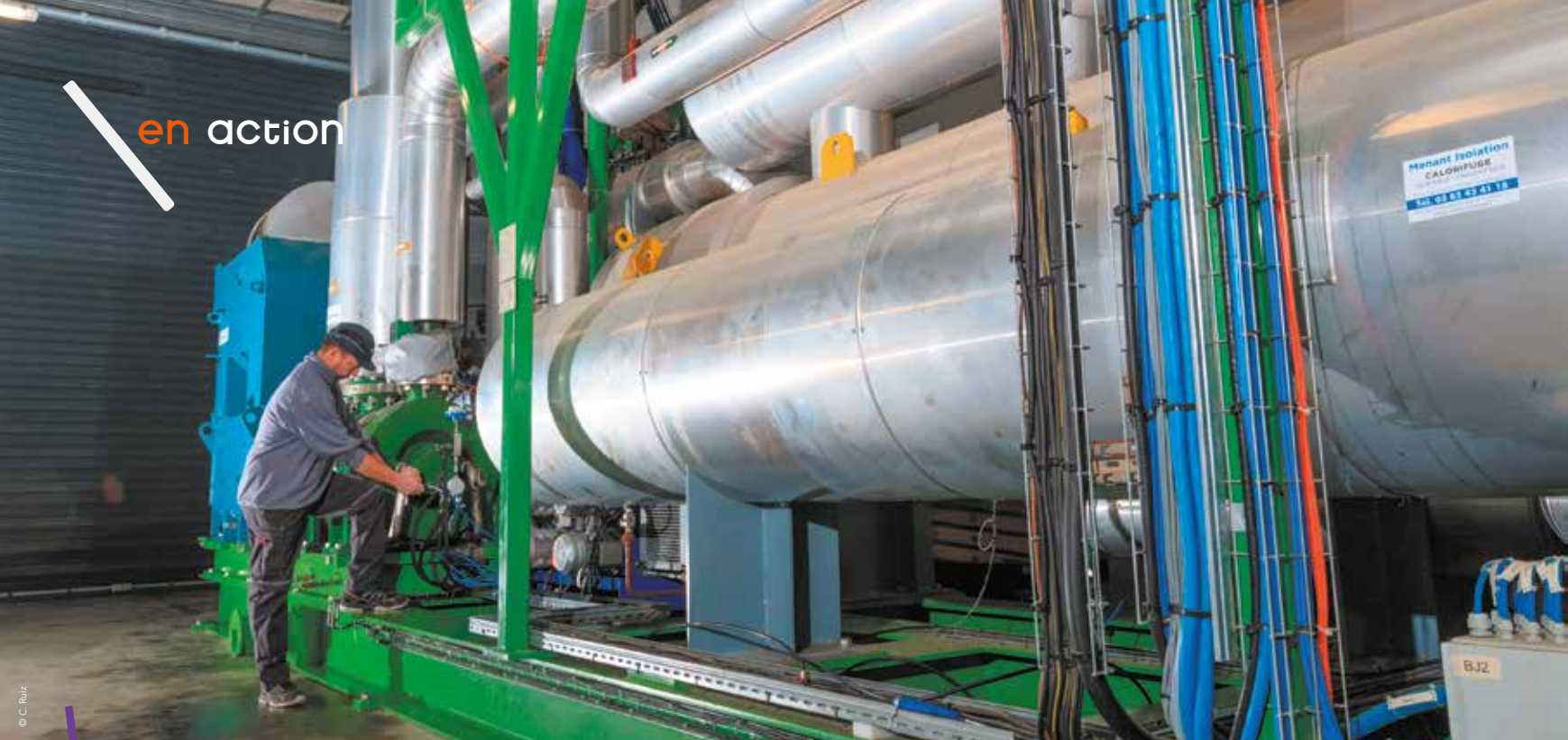
La centrale trigénération du réseau montpellierain de chaleur produit l'énergie nécessaire aux habitants des quartiers de Port-Marianne pour se chauffer.
