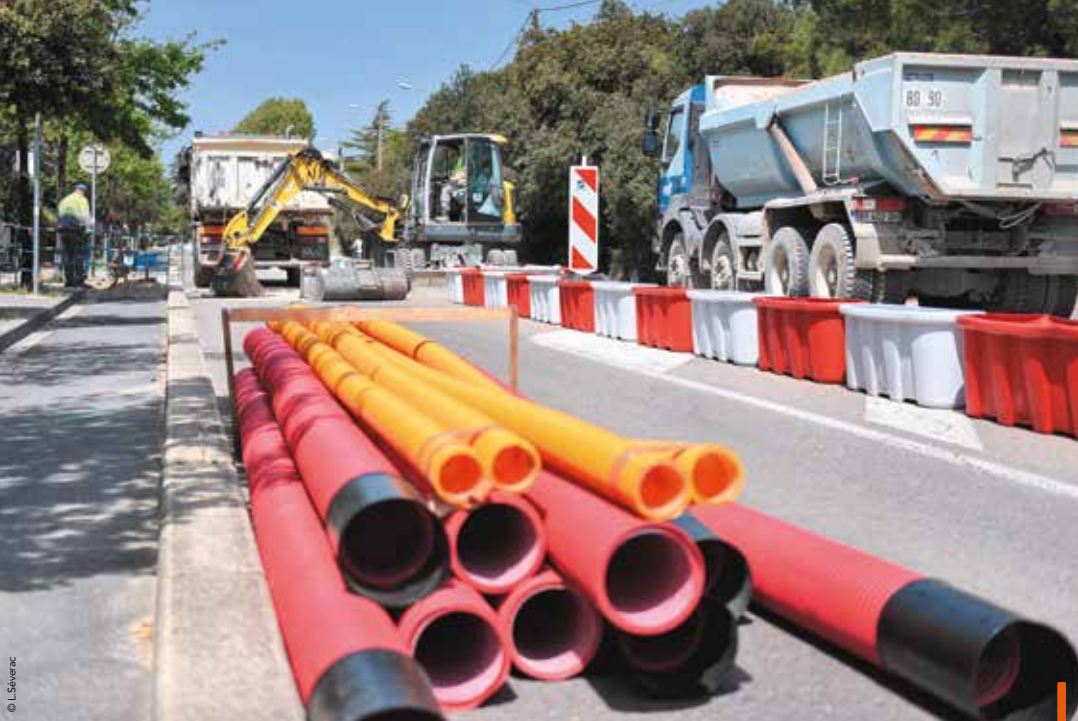
Le chantier de la ligne 5 est lancé route de Mende avec le dévoiement des réseaux.
