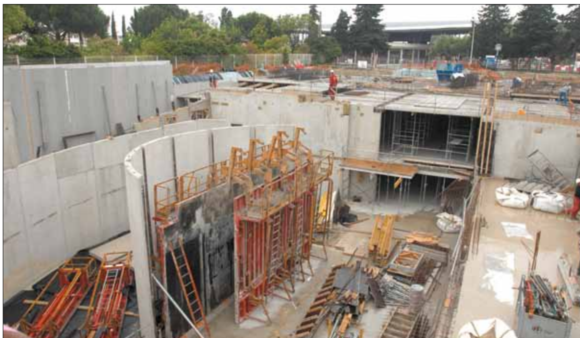
Les travaux du parking sont en cours à l'emplacement du « trou Arnal ».
