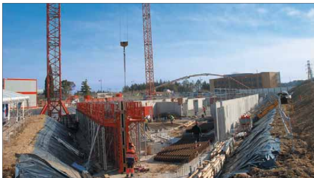
Le chantier du Pôle multi-services, à deux pas du MIBI (au fond à droite).
