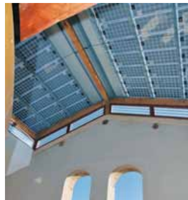
85 m 2 de capteurs photovoltaïques produiront 25% des besoins en électricité du bâtiment.
