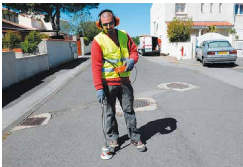
Écoute du réseau d'eau potable à la recherche de fuites éventuelles par les équipes de Véolia à Lattes.
